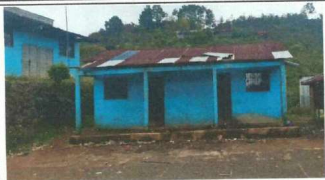
SUSTITUCIÓN DE TECHO YA QUE EL QUE TENEMOS ESTA EN PESIMAS CONDICIONES
